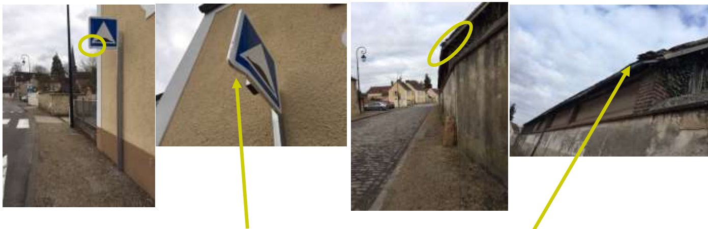
Un panneau, un toit et une gouttière abîmés suite au passage de camion sur les trottoirs
